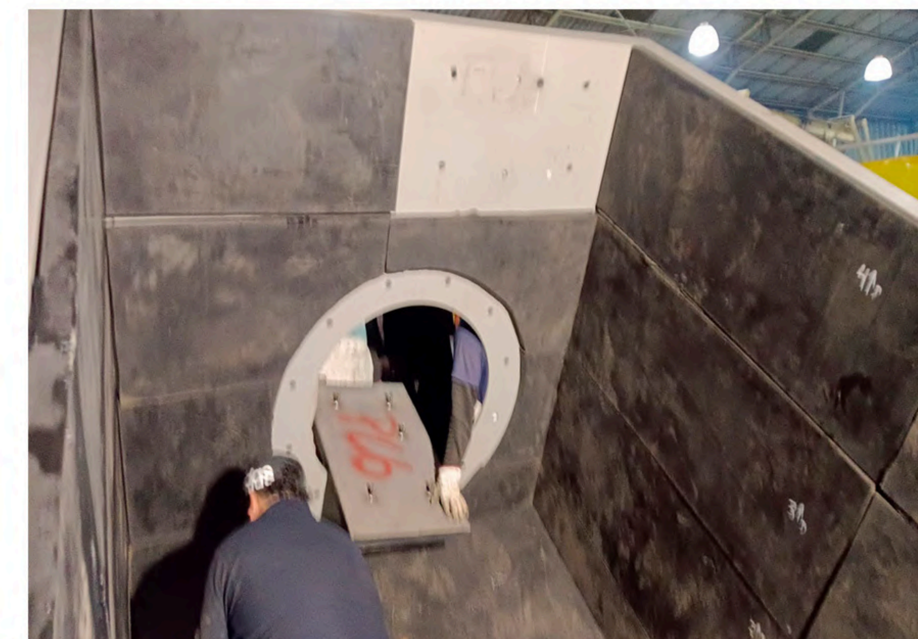
CAJON DE DISTRIBUCIÓN
